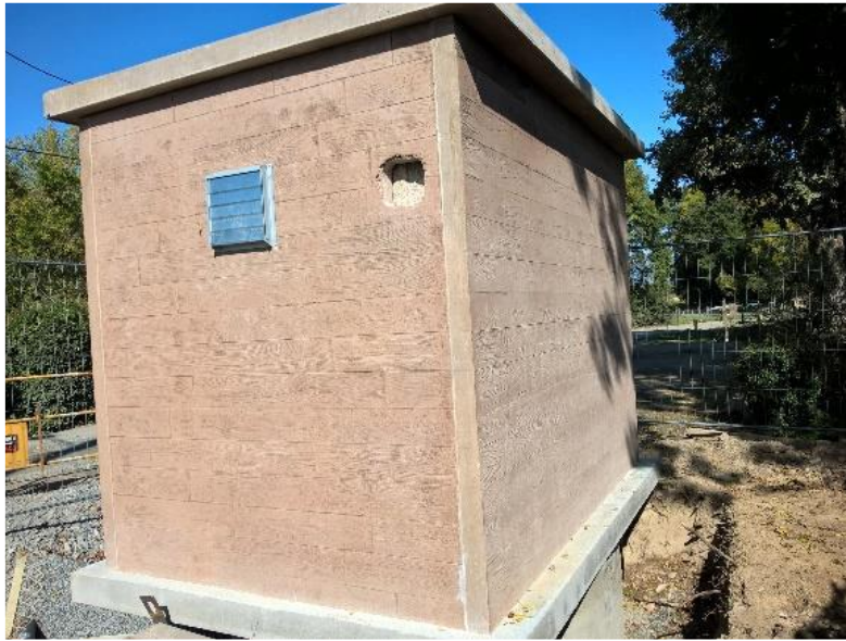
Exemple de local surpresseur. Source NTE. Étude technico-économique p.139
